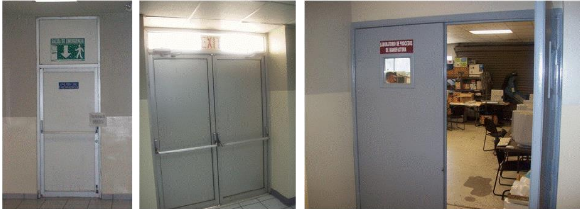
PUERTAS DE EMERGENCIA EN VIAS DE EVACUACION / PUERTAS RESISTENTES AL FUEGO EN LABORATORIOS Y AREAS CON RIESGO DE INCENDIO.
