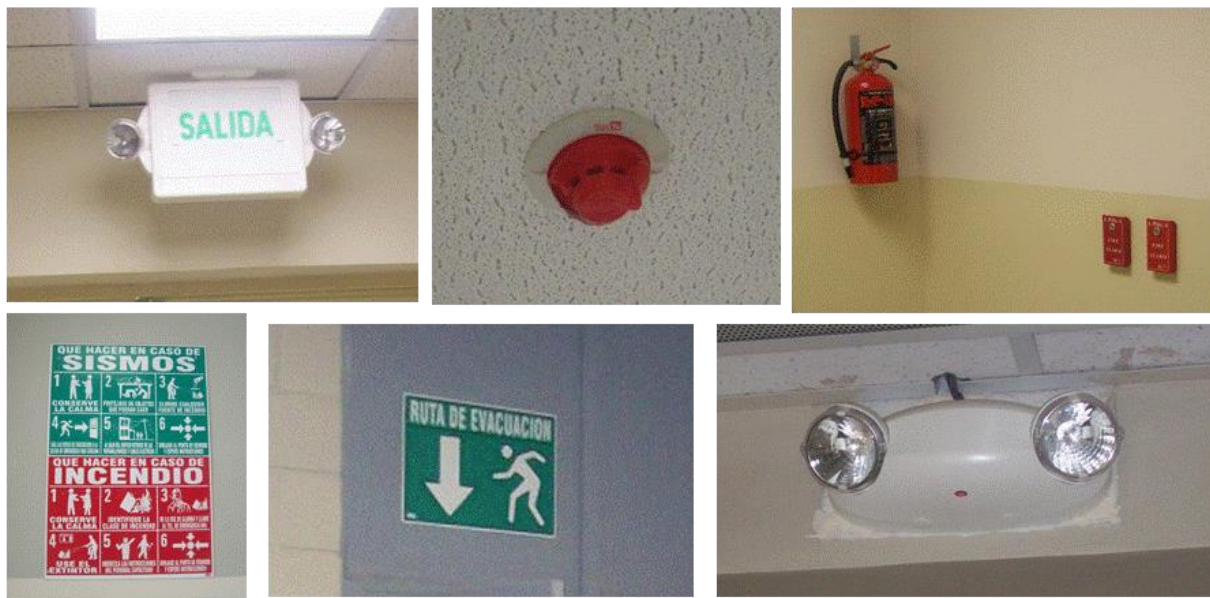
EQUIPOS DE DETECCION Y ALARMA CONTRA INCENDIOS, ILUMINACION DE EMERGENCIA Y SEÑALIZACION DE RUTAS DE EVACUACION Y SALIDAS DE EMERGENCIA.
